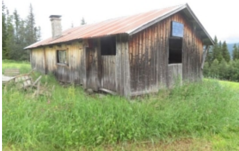
Sæl Eldre sæl i enklere uisolert stand. Større vedlikeholds- og ettersynsbehov.
