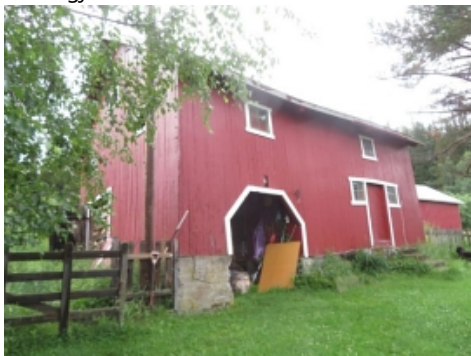
Stabbur Nedre langside av stabburet med adkomst til vognskjul/vedskåle. Merk påviste skjevheter og brudd i mur som følge av svikt i grunn.
