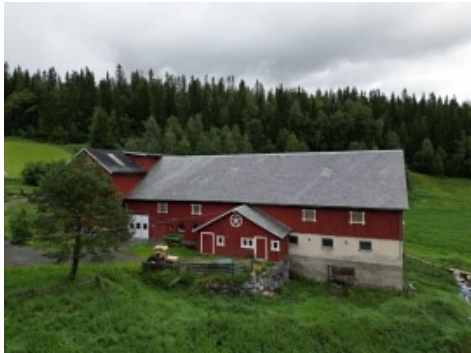
Driftsbygning Skifertekket tak på hoveddel og stålplattetekking på silobygget. Merk avskalling i puss overflater under vinduer.
