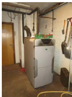
Vedfyrt sentralfyr i kjeller. Installert i 2010.
