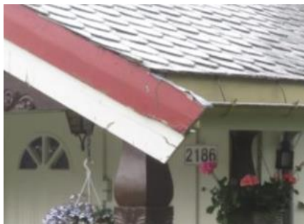
Fuktpåkjennning på nedre del av vindski.
