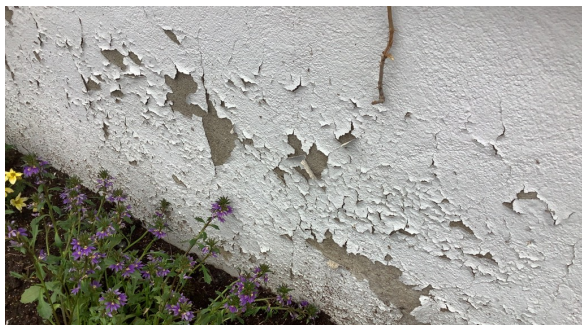
Eksempel på løsnet maling.
