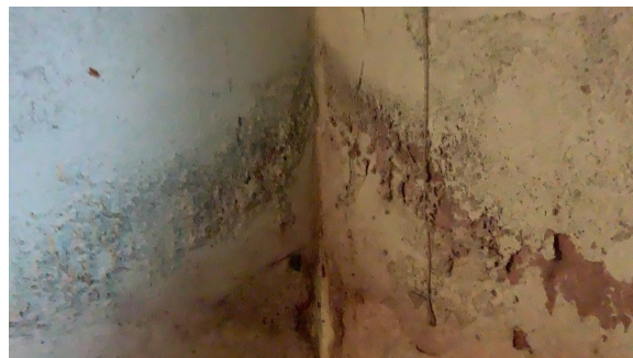
Eksempel på saltutslag.
