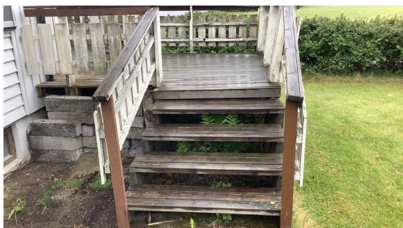
Rekkverket har skjevheter.
