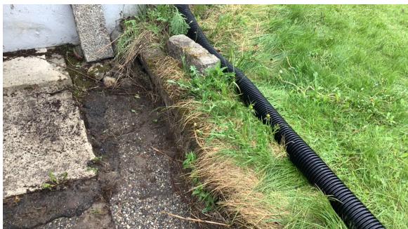
Skjev forstøtningsmur som følge av marktrykk.
