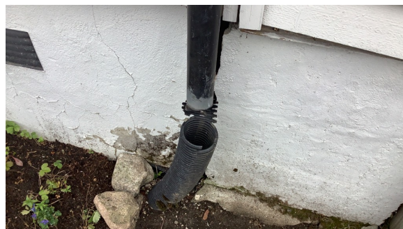
Utett overgang mellom nedløpsrør og drensrør.
