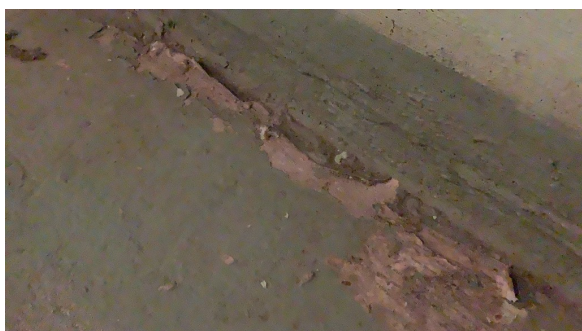
Eksempel på saltutslag.
