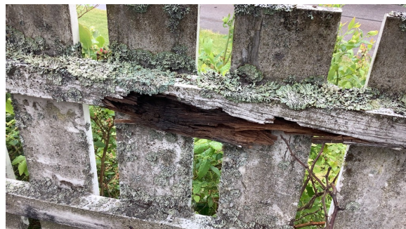
Råteskadet spikerslag på rekkverk.
