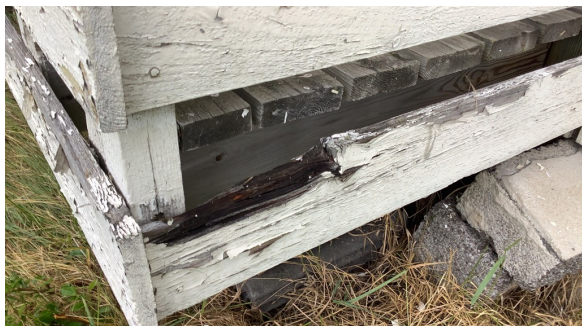
Råteskadet rekkverksbord på luftebalkongen.
