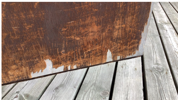
Slitasje på balkongdør i stue.
