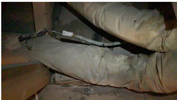
Fuktskjolder på isolasjon nedenfor luftehatt.
