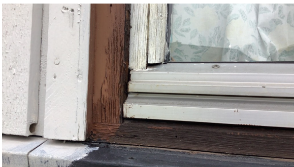
Eksempel på værslitt vindu.
