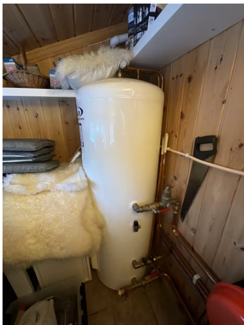
Viser bereder plassert i bod med utvendig adkomst.
