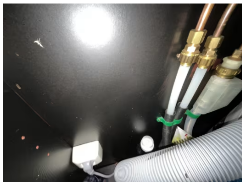
Manglende endemuffer ved røravslutninger ved rør i rør system inne i kjøkkenbenk.
