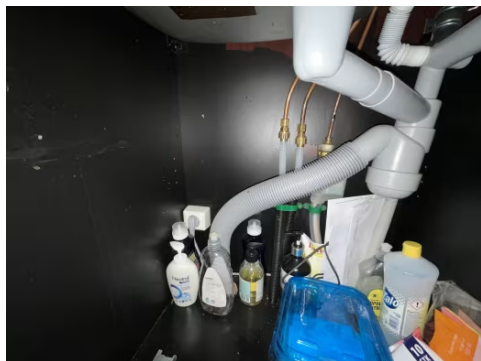
Viser vann og avløpsinstallasjoner under kum.
