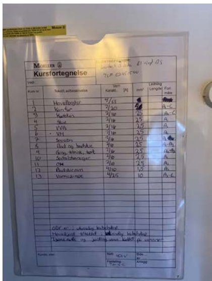
Viser kursfortegnelse i sikringsskap.
