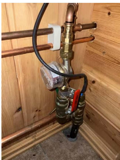
Viser vanninntak, hovedstoppekran og vannmåler. Varmekabel montert på tilførsel.
