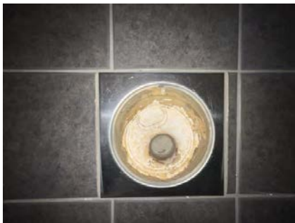
Viser sluk i dusjsonen.
