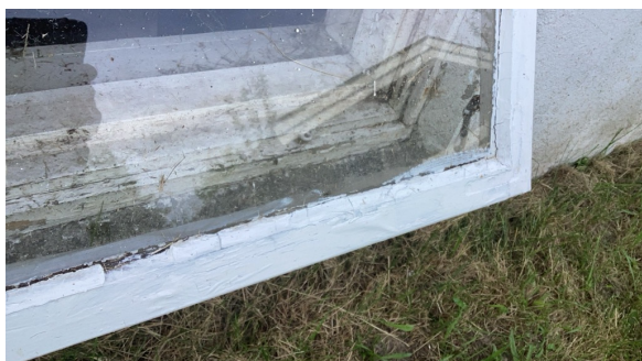
Eksempel på slitasje.
