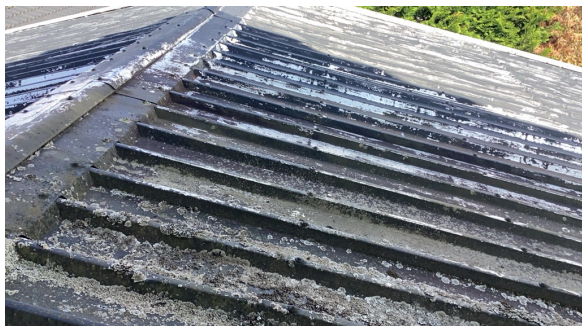
Avskaling av farge på tekking på tilbygget del.
