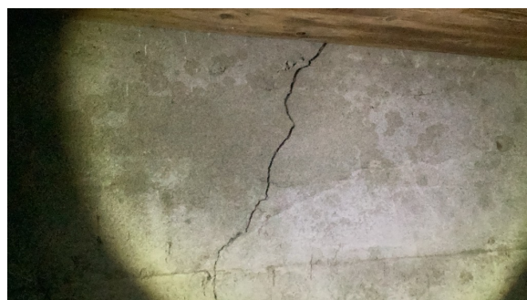
Eksempel på sprekk i grunnmur
