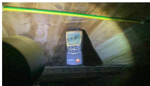
Fuktinnhold i treverk på over 20 vektprosent.
