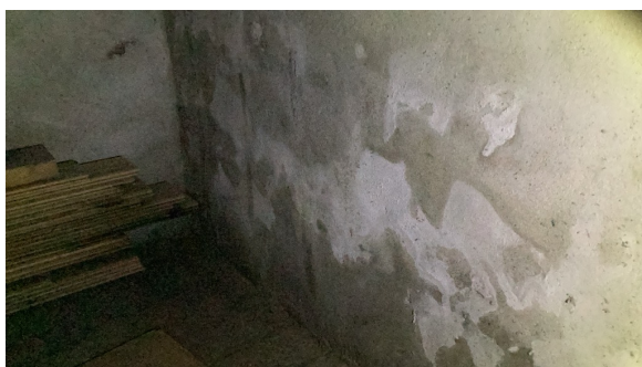
Eksempel på fuktpåkjenning på vegg
