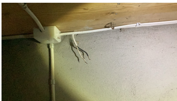
Eksempel på løs ende på kabler.
