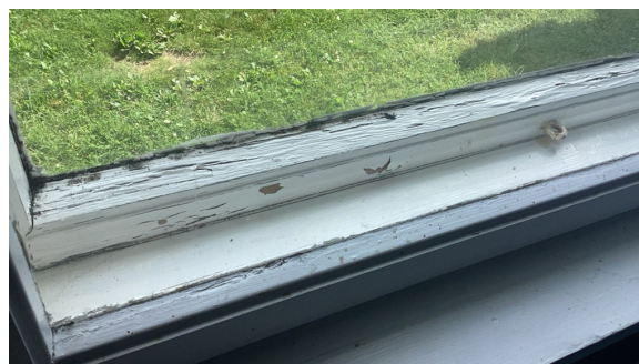
Eksempel på slitasje.
