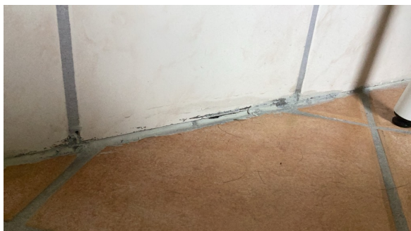
Det er noen steder sprekk i silikon mellom gulv og vegg.
