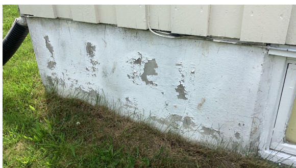
Eksempel på avskaling av maling.
