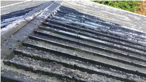
Avskaling av farge på tekking på tilbygget del.
