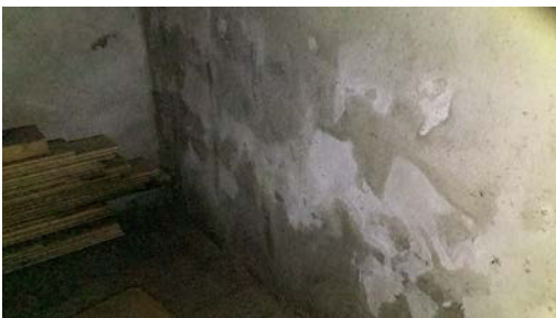
Eksempel på fuktpåkjenning på vegg
