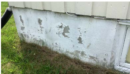
Eksempel på avskaling av maling.
