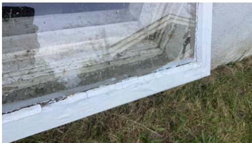
Eksempel på slitasje.
