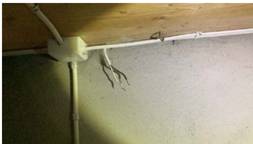
Eksempel på løs ende på kabler.
