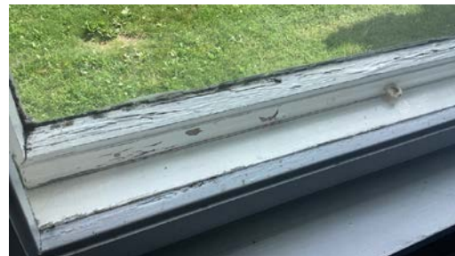
Eksempel på slitasje.
