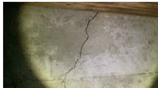
Eksempel på sprekk i grunnmur
