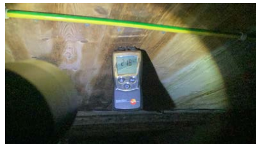
Fuktinnhold i treverk på over 20 vektprosent.
