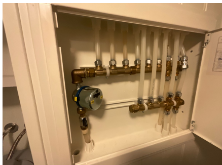
Rørskap med vannmåler og stoppekran.
