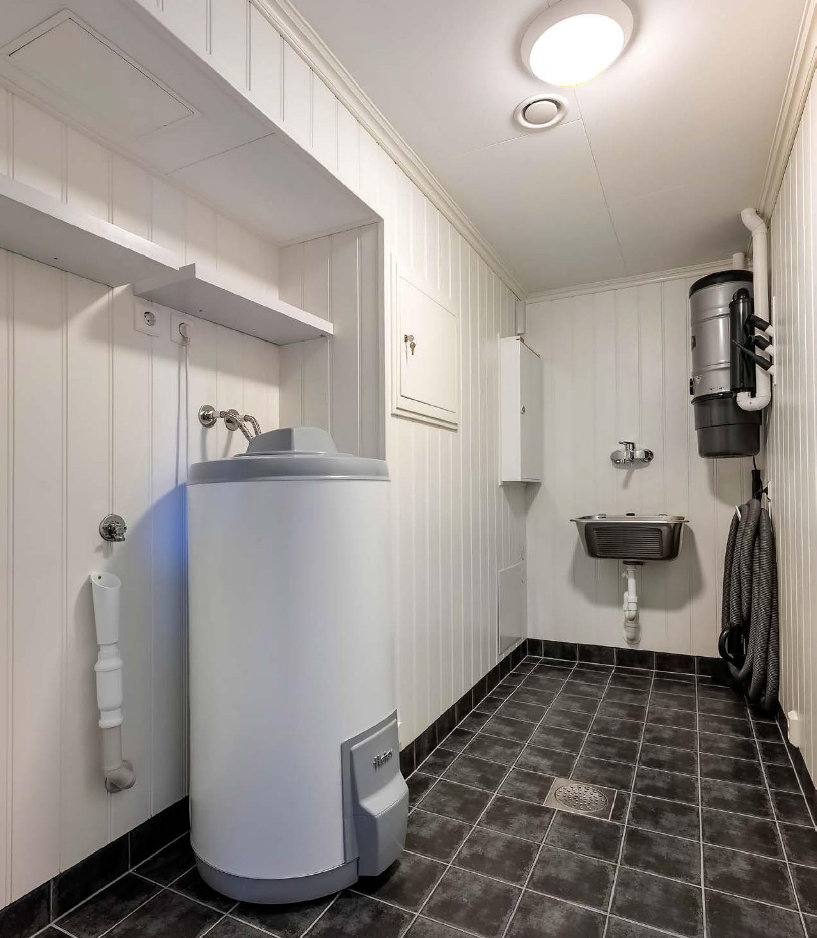
Praktisk vaskerom med gulvvarme og skyllekar - Rommet huser også det meste av leilighetens tekniske utstyr
