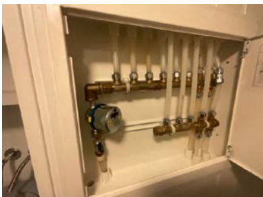
Rørskap med vannmåler og stoppekran.
