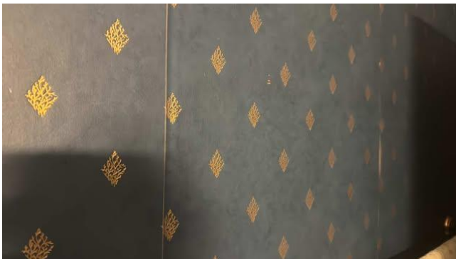
Skjøter på tapeten som har svellet.
