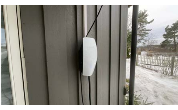
Lagt opp til elbillader.
