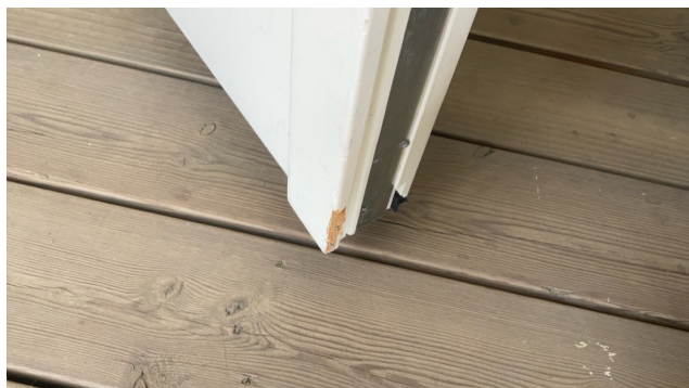
Skade i nedre del på terrassedør.
