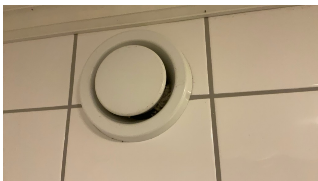
Ventilasjonskanal på bad.
