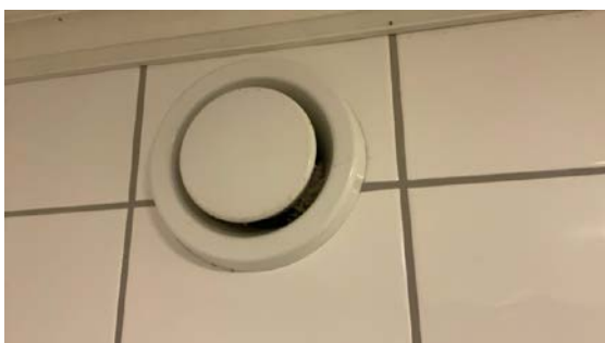
Ventilasjonskanal på bad.
