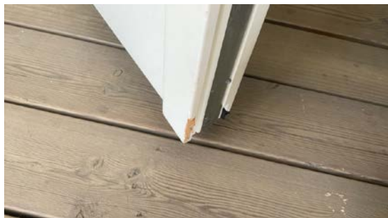
Skade i nedre del på terrassedør.
