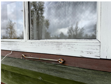
Vedlikeholdsbehov på enkelte vindu
