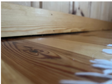
Glippe mellom gulv/gulvlist under stuevindu
