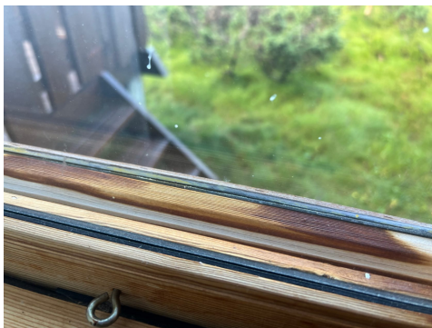
Skjold i karm som følge av kondens
