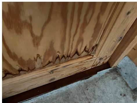
Fuktskjolder i dør til teknisk rom
