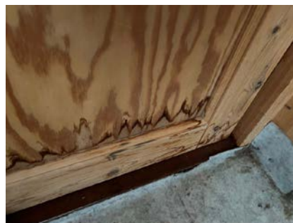
Fuktskjolder i dør til teknisk rom
