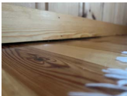
Glippe mellom gulv/gulvlist under stuevindu
