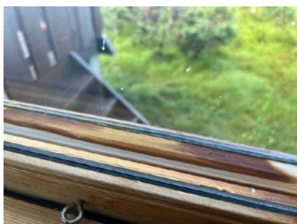
Skjold i karm som følge av kondens
