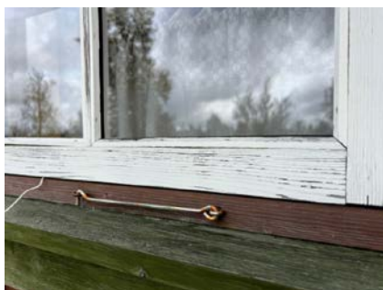
Vedlikeholdsbehov på enkelte vindu
