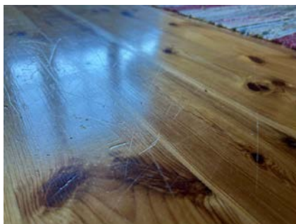
Bruksslitasje/riper på gulvoverflate
