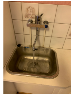
Noe treg avrenning fra utslagsvask
