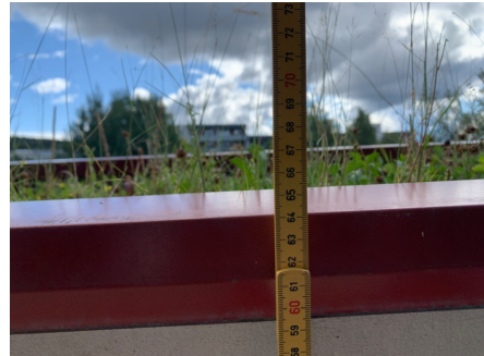
For lav høyde på "rekkverk"
