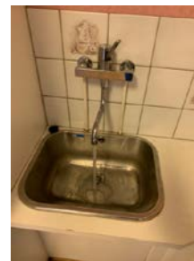
Noe treg avrenning fra utslagsvask
