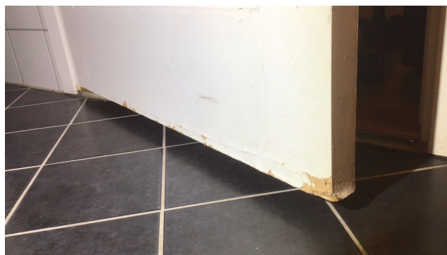
Badedør har skader i nedkant
