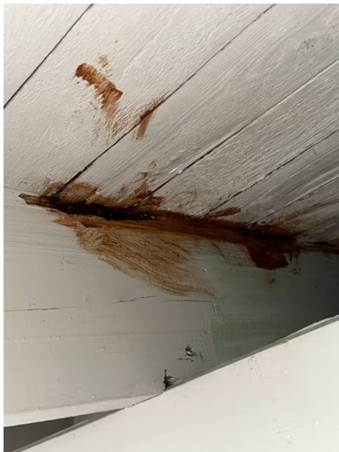
Viser råteskader ved undertak og sperre ved pipe. Tidligere skade etter utettheter ved pipe.
