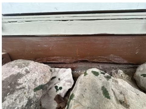
Trevirke med tidligere råteskade behandlet godt med beis. Antatt fuktopptrekk fra grunnmur eller
