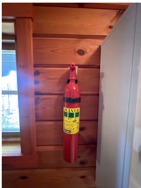
Viser eldre brannslukningsapparat.
