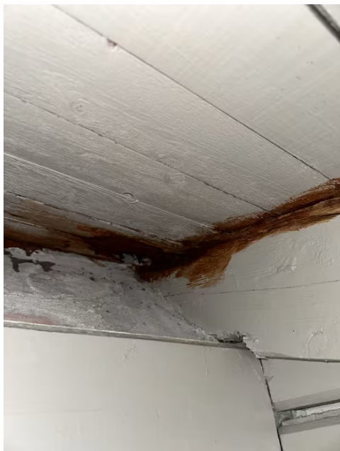
Viser råteskader ved undertak og sperre ved pipa. Tidligere skade etter utettheter ved pipe.
