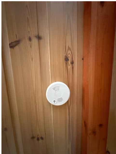
Viser brannvarsler montert i himling.
