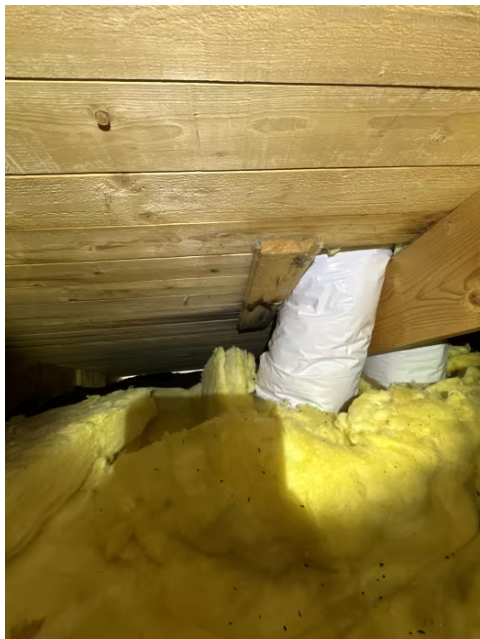
Det registreres fuktmerker rundt takgjennomføring. Antatt eldre forhold.
