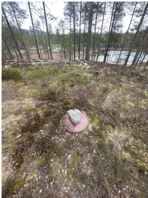
Viser utvendig kum. Ikke inspisert.
