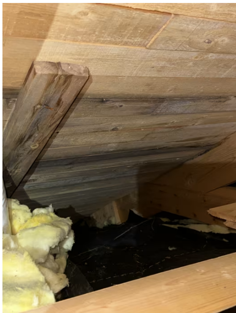
Det registreres svertesopp i undertak.
