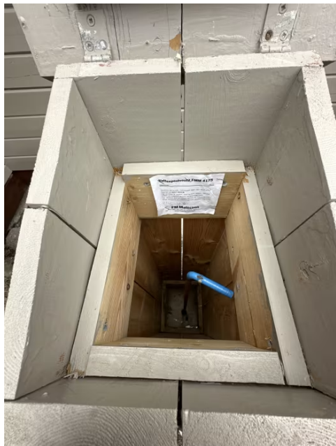
Viser utvendig stoppekran.
