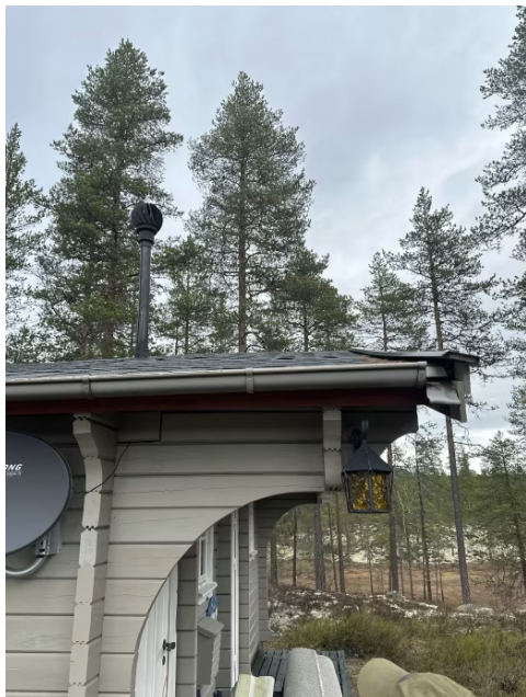
Viser ufagmessig utførelse ved takrenne.
