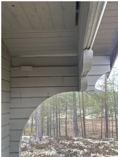
Det registreres svai/nedbøy i takflaten ved inngangsparti.
