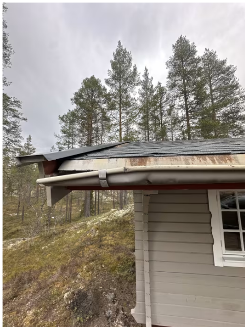
Det registreres nedbøy/skjevheter i takrenner.
