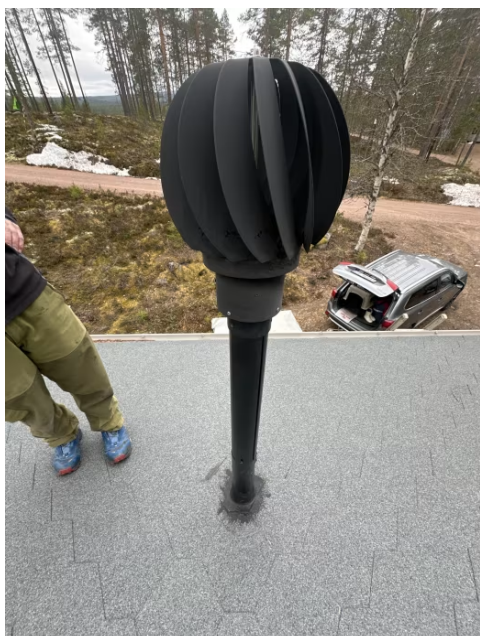
Viser lufting av avløpsanlegget.
