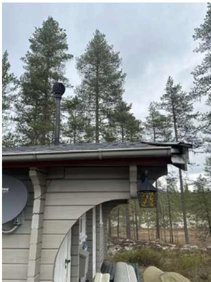
Viser ufagmessig utførelse ved takrenne.
