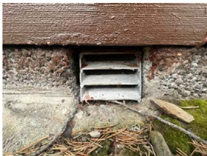
Viser lufteluke tilknyttet krypkjeller. Det registreres utettheter rundt ventil.
