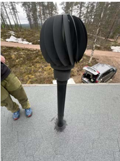
Viser lufting av avløpsanlegget.
