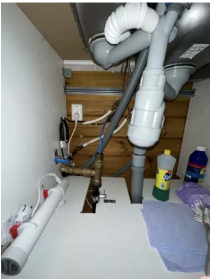
Viser vann og avløpsinstallasjoner under kum.
