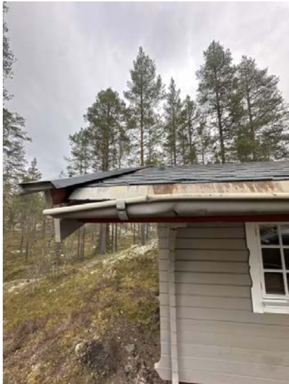
Det registreres nedbøy/skjevheter i takrenner.
