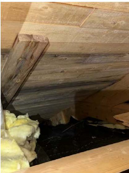
Det registreres svartesopp i undertak.
