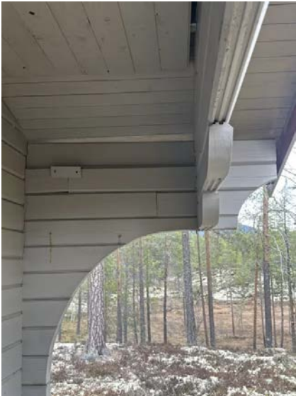
Det registreres sva/hedbøy i takflaten ved inngangsparti.
