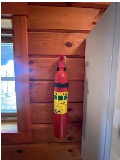
Viser eldre brannslukningsapparat.
