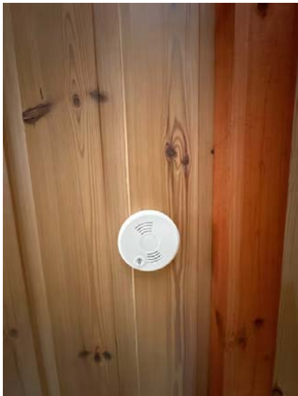
Viser brannvarsler montert i himling.
