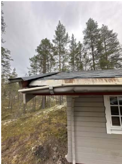
Det registreres nedbøy/skjevheter i takrenner.
