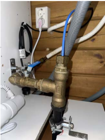
Viser vanninntak og hovedstoppekran under kum på kjøkken. Det registreres kondens på rør og koblinger.
