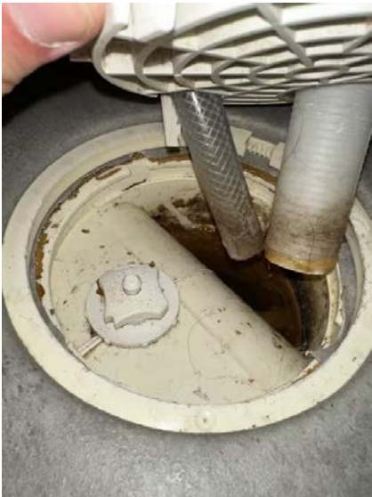
Viser sluk plassert under dusjkabinett. Synlig vinyl under klemring.
