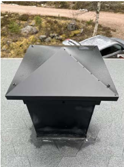
Viser lufting fra ventilator på kjøkken og naturlig ventilasjon på bad.
