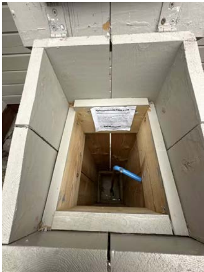
Viser utvendig stoppekran.
