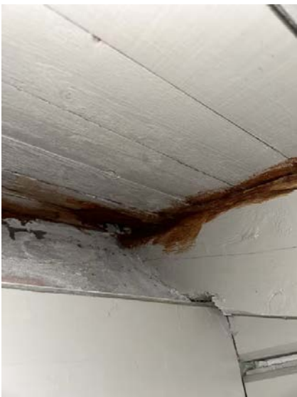
Viser råteskader ved undertak og sperre ved pipa. Tidligere skade etter utettheter ved pipe.
