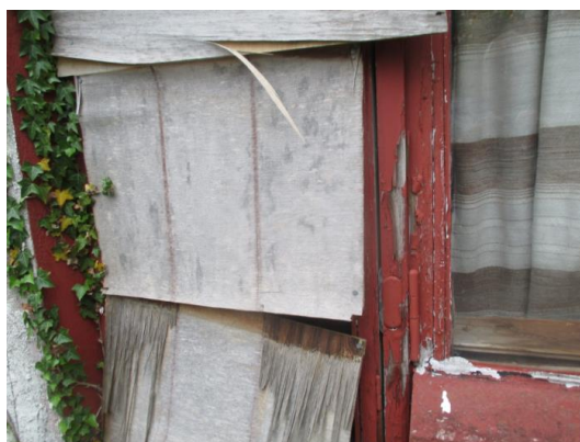
Større skader på balkongdører.
