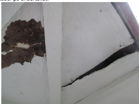
Utvendig gesimser har fått større skader.
