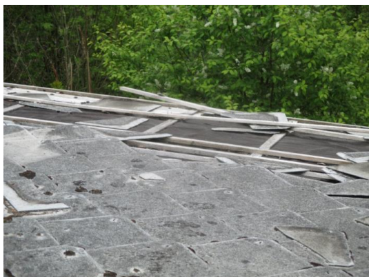
Større skader på opprinnelig del
