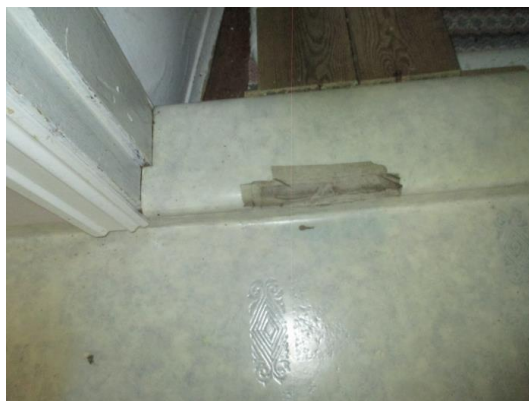
Skade ved oppkant.
