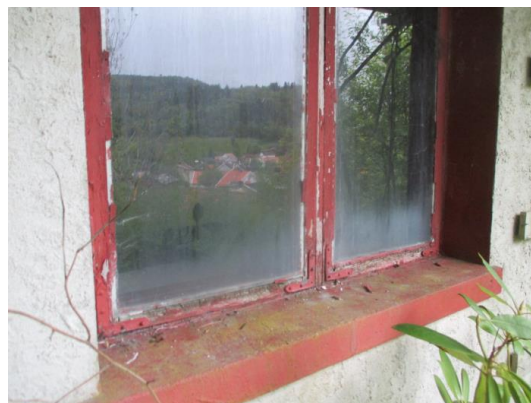
Eldre slitte/skadet vinduer.
