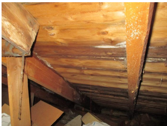
Fuktskader på undertaket.
