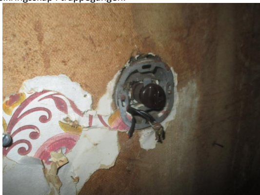
En del åpne skadet føringer og brytere.
