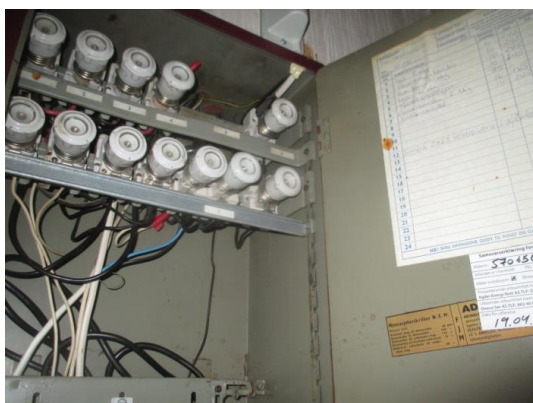
Eldre sikringsskap i trappegangen.
