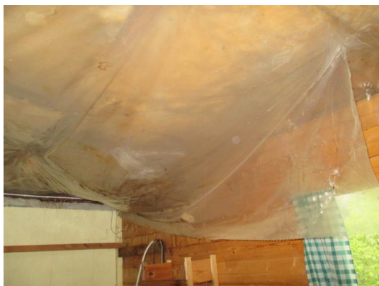
Skadet himling i verksted.
