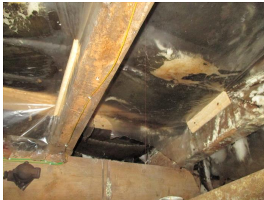
Undersiden av skadet etasjeskille i bod.
