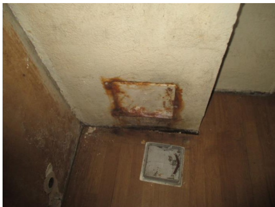
Eldre skadet sotluke.
