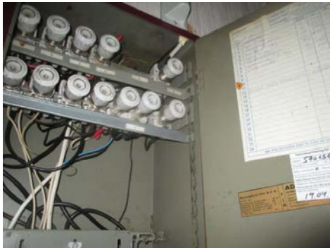
Eldre sikringsskap i trappegangen.
