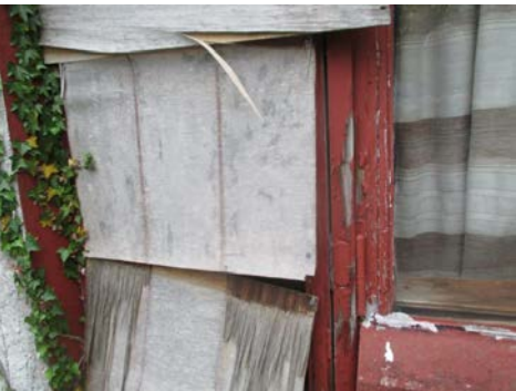
Større skader på balkongdører.
