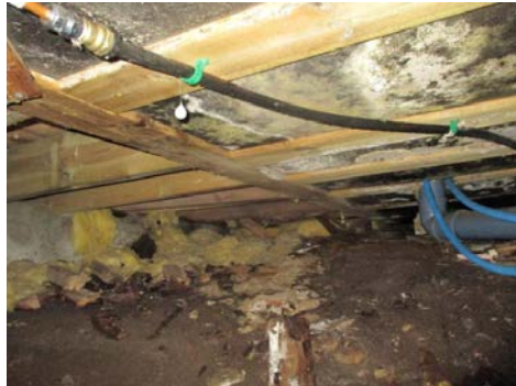
Større skader på stubbloftet som har ramlet ned flere plasser.
