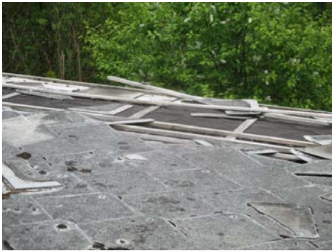
Større skader på opprinnelig del
