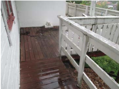
Trenger større oppgraderinger.
