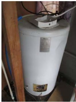
Eldre slitt og skadet bereder.
