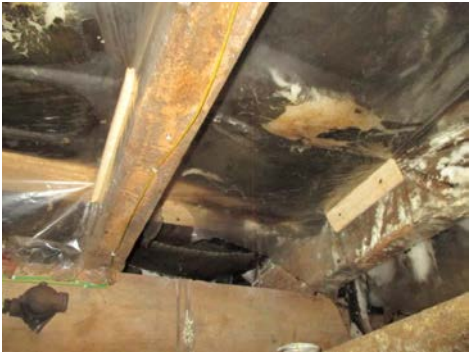
Undersiden av skadet etasjeskille i bod.
