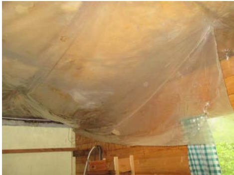
Skadet himling i verksted.
