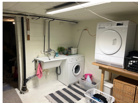
Vaskerom i kjeller.
