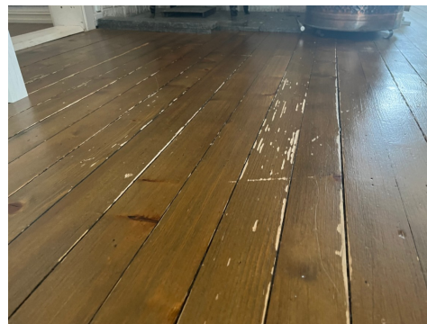
Slitasje på tregulv.
