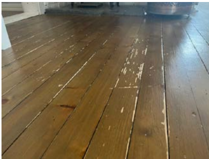
Slitasje på tregulv.
