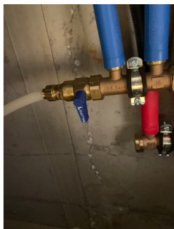
Hovedstoppekran plassert bak luke i bad
