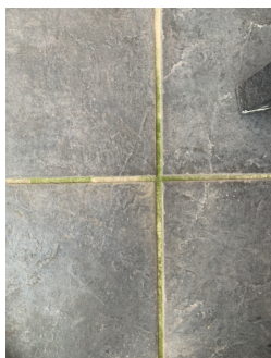
Balkongen er i normalt god stand, men har etterslep av rengjøring (gulvfliser)
