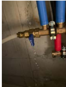
Hovedstoppekran plassert bak luke i bad
