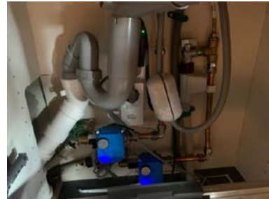
Rørapplegget i kjøkkenet. Synlig waterguard
