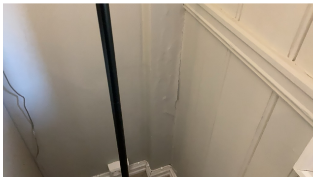
Synlig avflassing av veggmalings på hjørnekonstruksjon, fukt er nærliggende årsak og må holdes under tilsyn
