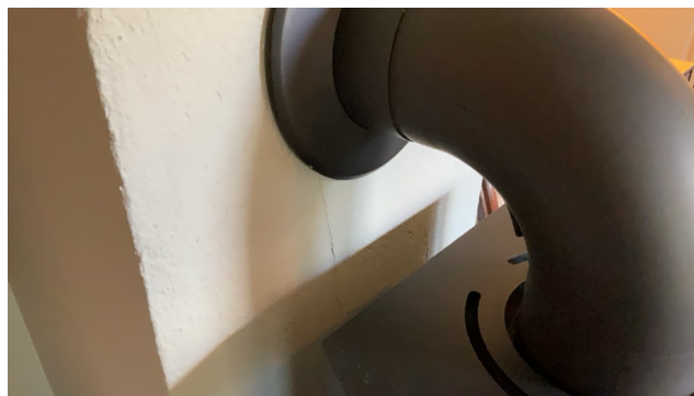
Bemerket riss på pipe ved røykrør, anbefaler kontroll
