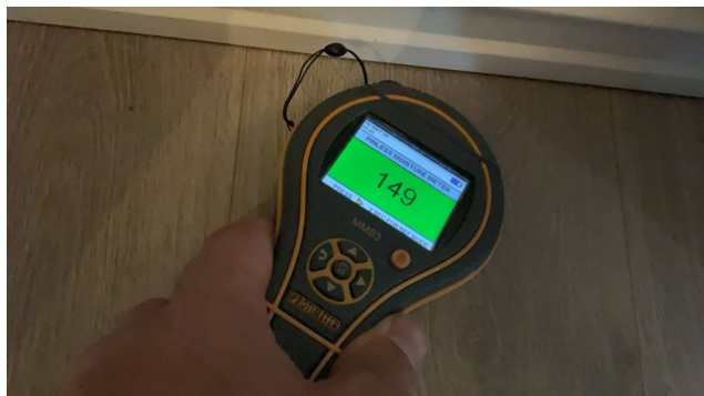
På gulv mot grunn fra gang ved bad var det ikke utslag
