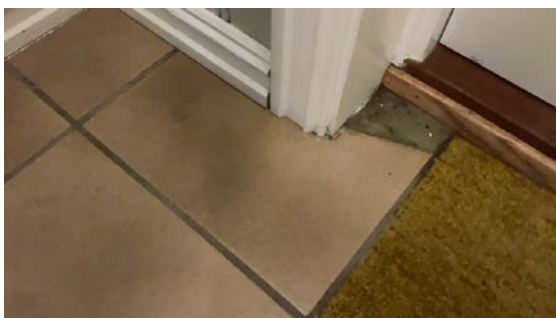
Bom i enkelte fliser og mangler deler av en flis der tiltak med utskifting av fliser i sin helhet må påregnes
