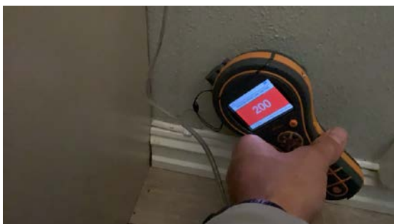
På vegg/murkonstruksjon mot terreng i stue/kjøkken mot østlig retning fuktutslag, noe som gir grunn for at konstruksjonen må holdes under tilsyn, ved utvikling av fukt må tiltak vurderes og alder/tilstand på drenering er avgjørende
