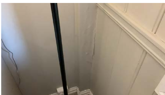
Synlig avflassing av veggmalning på hjørnekonstruksjon, fukt er nærliggende årsak og må holdes under tilsyn
