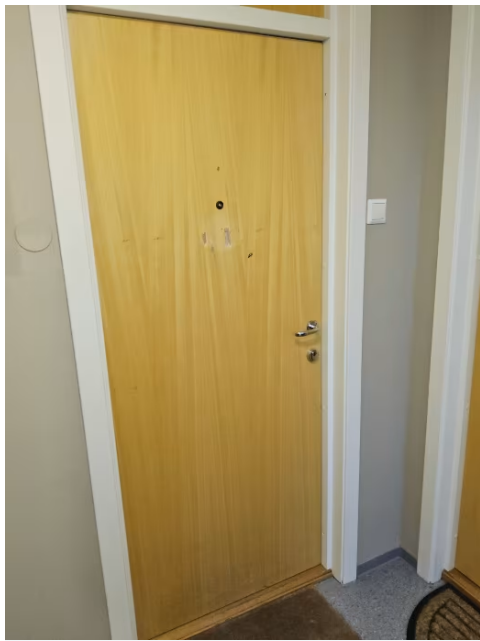
Entrédør har enkelte kosmetiske skader.
