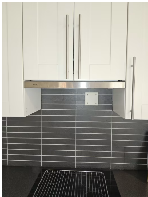
Integrert kjøkkenventilator i overskap.
