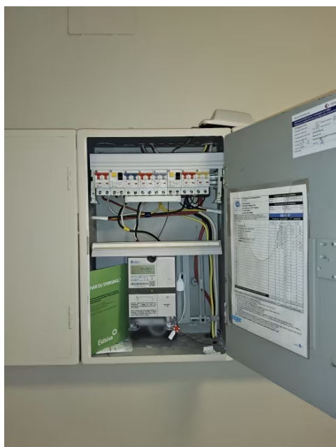
Sikringsskap er plassert i felles gang.
