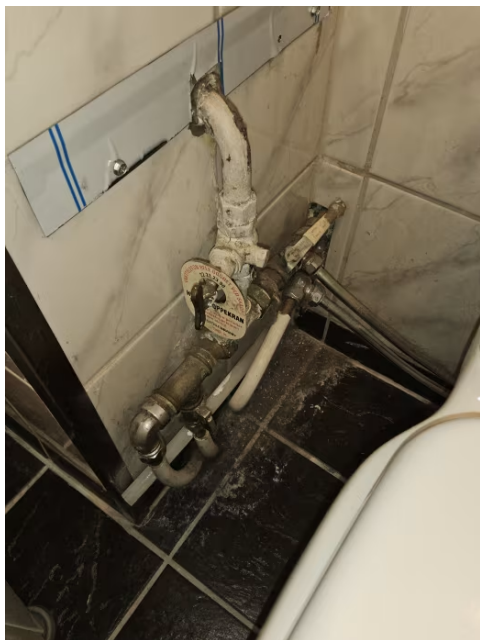
Enkelte deler av røropplegget bærer preg av alder.
