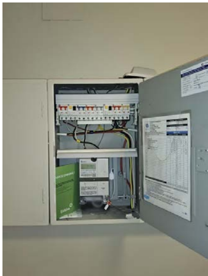
Sikringssskap er plassert i felles gang.
