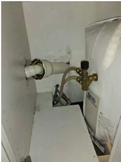
Leiligheten har synlige avløpsrør av plast og støpejern.
