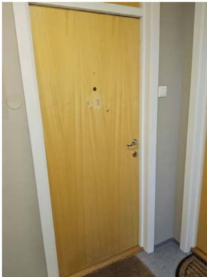
Entrédør har enkelte kosmetiske skader.
