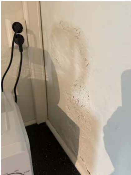
Det registreres mineralutslag (salt/kalkutsalg) i overflater som er et symptom på fuktvandring gjennom grunnmur.
