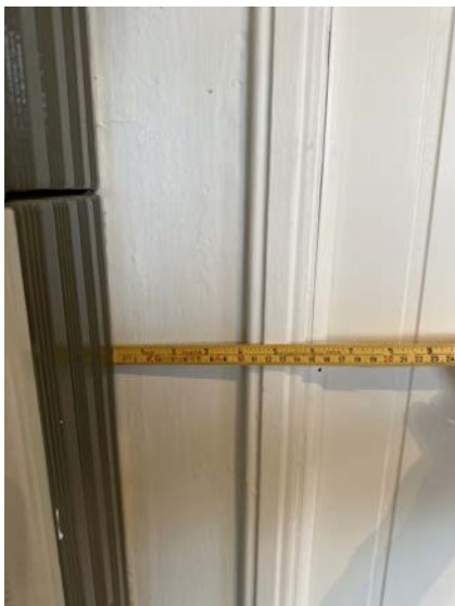
Det registreres kort avstand mellom ildsted og brennbart materiale.
