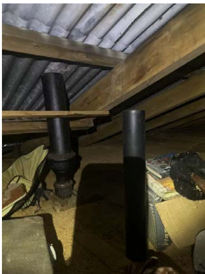
Lufting er ikke ført over tak. (TG2)
