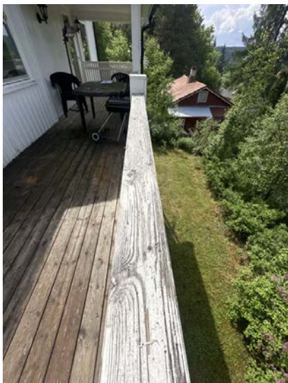
Konstruksjonen mangler overflatebehandling.
