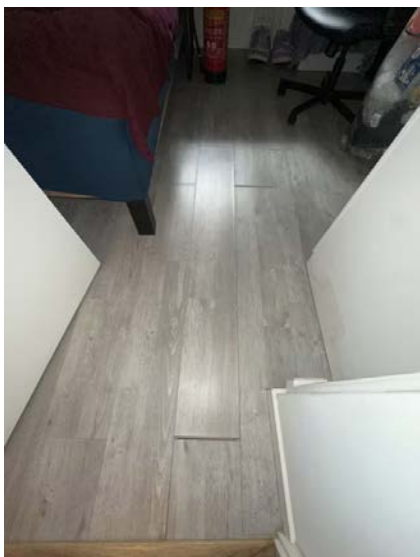
Det registreres glipper mellom skjøter i gulv.
