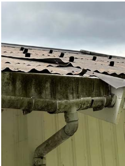
Viser skjevheter ved takrenner og løs taktekking.
