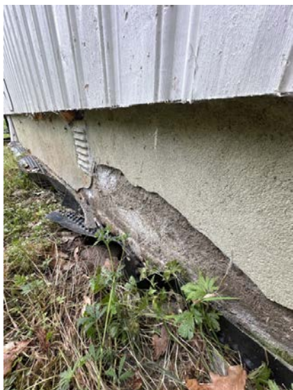
Grunnmur mangler stedvis overflatebehandling / puss.
