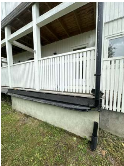
Viser skader på renner og nedløp. Nedløpsrør ikke tilknyttet drensør.
