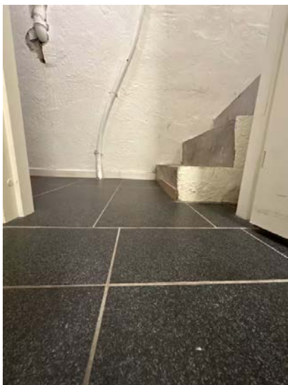
Ingen synlig tettesjikt ved døråpning.
