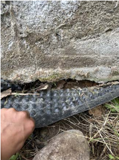
Det er registrert utsigning av masser under grunnmuren.
