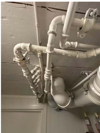
Det registreres vannråper på fordelere og rør i kjeller. Anbefaler ytterligere undersøkelser.
