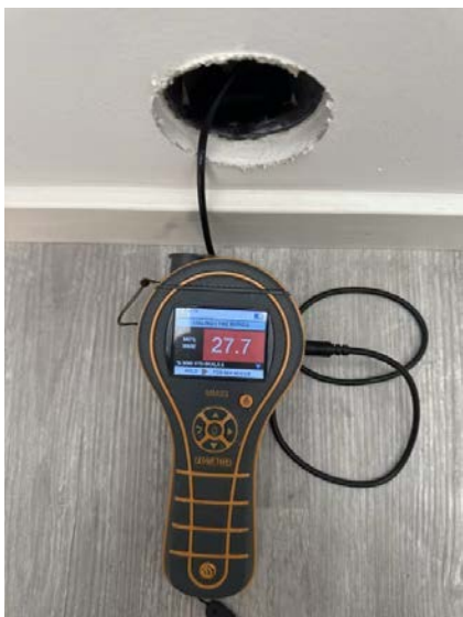
Ved fuktmåling i treverk i forbindelse med hulltaking, viser fuktverdier over faregrense for utvikling av sopp/ råteskader.
