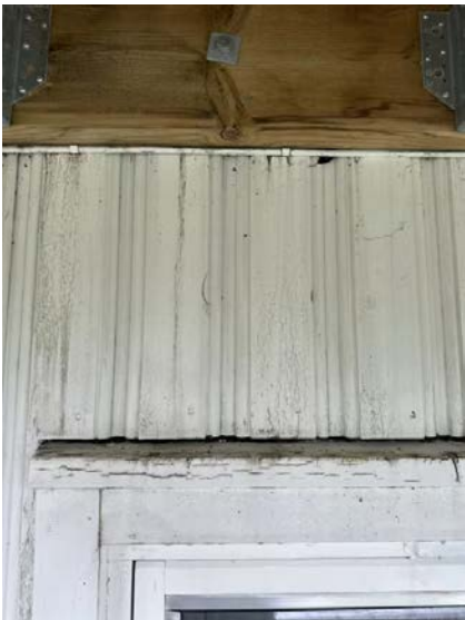
Vann renner fra balkong i 2.etasje og på vannbrett. Beslagløsninger anbefales.
