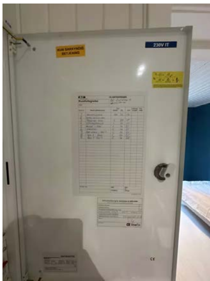
Viser kursfortegnelse i skap i 1.etasje. Måler opplyst for 1.etasje og kjeller.
