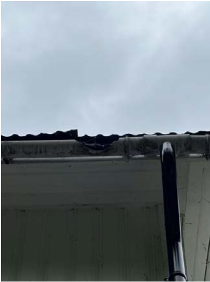
Viser sprekke i takrenne.
