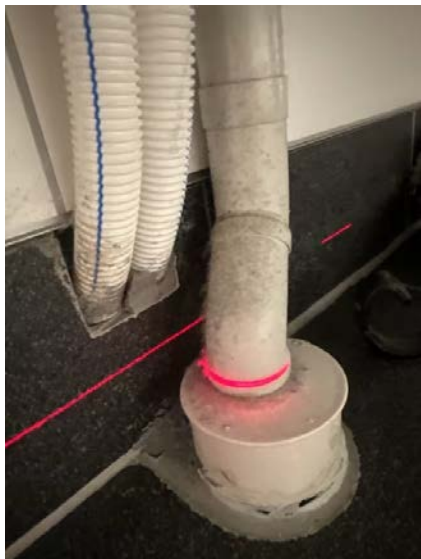
Rørføringer gjennom gulv/vegg har ikke synlig membran / mansjetter.
