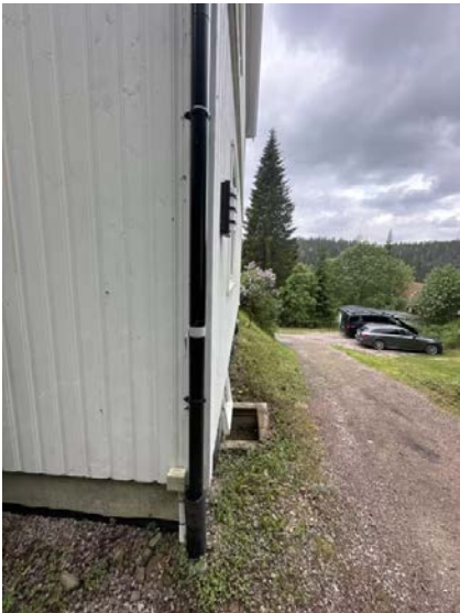
Viser nedløpsrør ført videre i drenerør.
