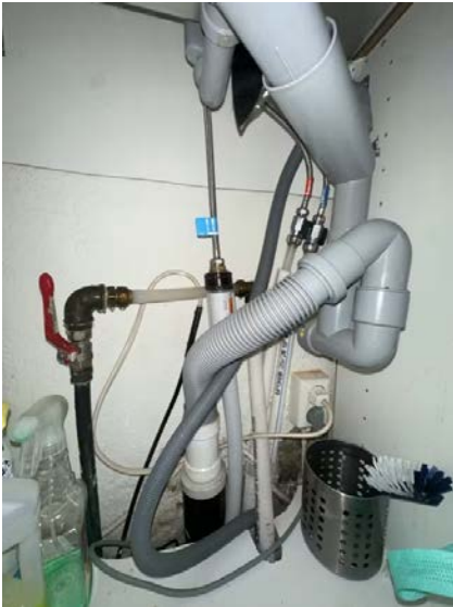
Viser vann og avløpsinstallasjoner under kum. Det registreres kondens og vanddrypp fra vannrør.
