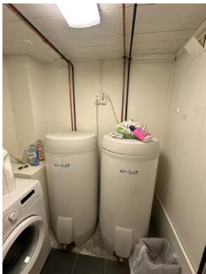
Viser beredere plassert på vaskerom i kjeller.
