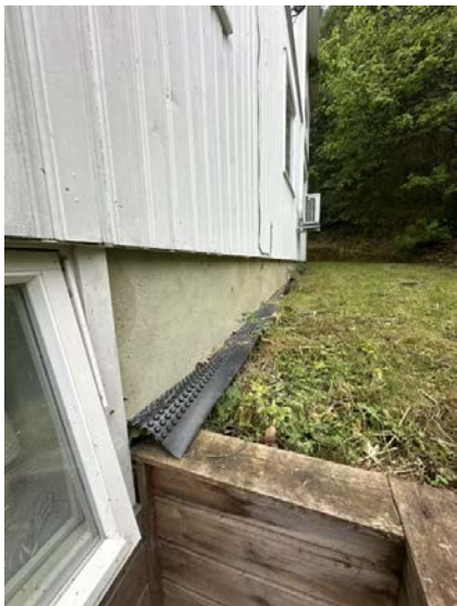
Viser manglende topplatt ved knotteplast. Topplatt må etableres ved knotteplast.
