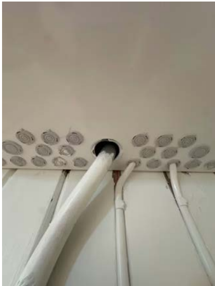
Det er hull/innføringer i inntak eller sikringssskap som ikke har nippelinnføringer eller er tettet med masse beregnet for formålet.
