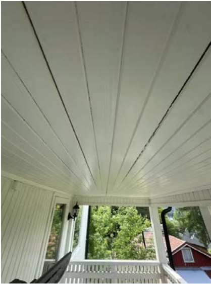
Det registreres sprekker i tak ved overbygg.
