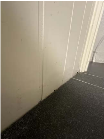
Det registreres svelleskade på mdf plater
