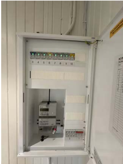
Viser sikringssskap i 1.etasje.
