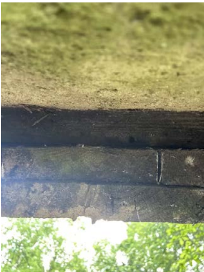
Det registreres manglende lufting bak kledningen.
