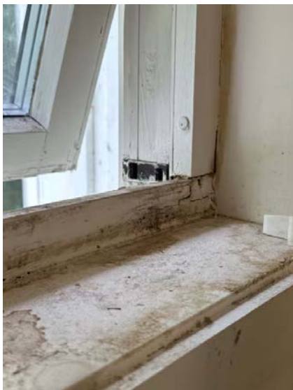
Det registreres råteskader i vindu plassert i våtsonen.
