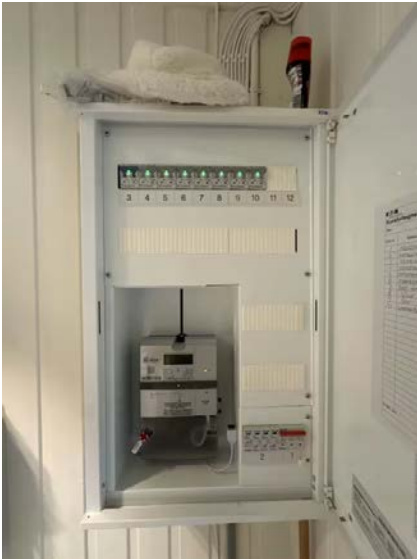
Viser sikringsskap plassert i 2.etasje med jordfeilautomater og måler.
