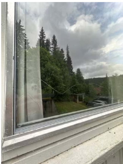
Viser knust glass ved vindu i 1.etasje
