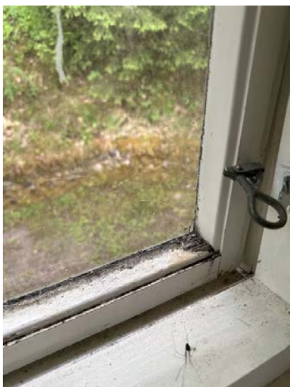
Viser eksempel på råteskade i vindu.
