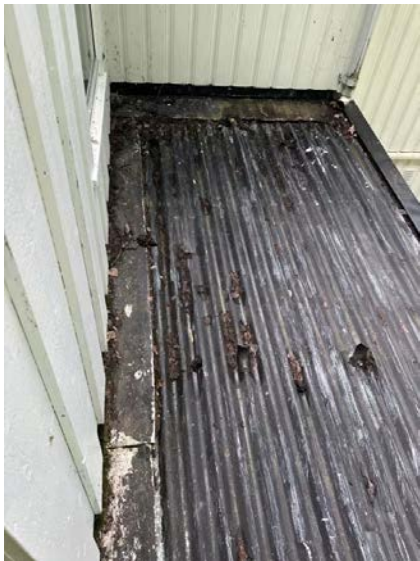
Viser slitasje ved tekking over inngangsparti.
