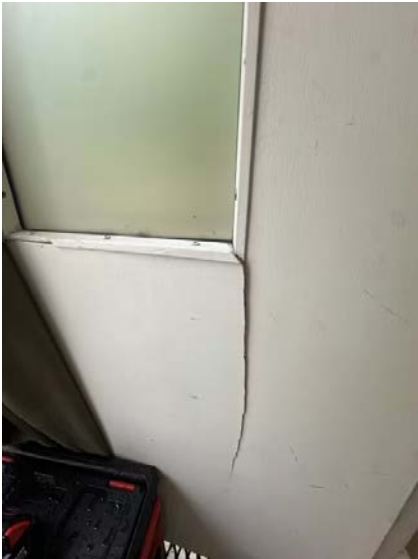
Viser skade på ytterdør.
