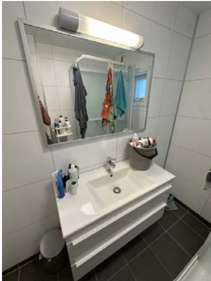
Viser baderomsinnredning. Det registreres sprekk i speil.
