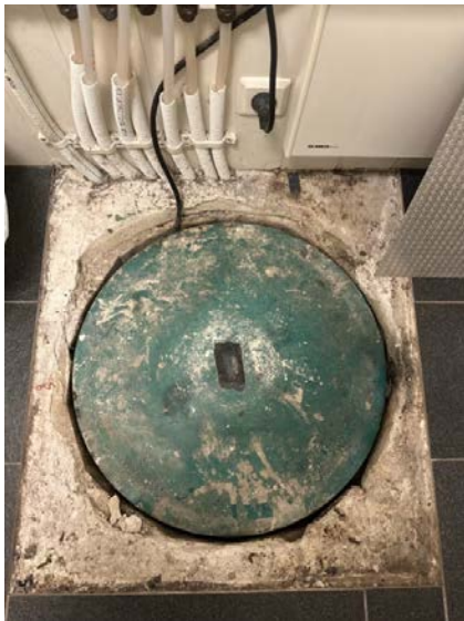
Viser pumpekum for avløpsanlegg i kjeller.
