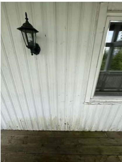
Det drypper fra balkong i 2.etasje og ned på yttervegg som vil skaper skader på sikt. Tiltak må påregnes.
