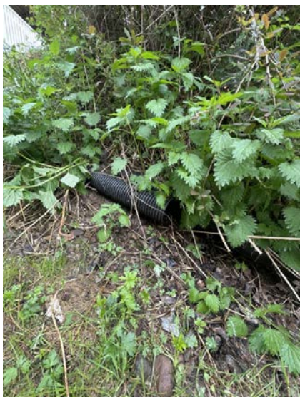
Viser drensrør fra nedløpsrør. Eier opplyser om at det kan forekomme vond lukt fra drensrør. Anbefaler yttersøkelse.
