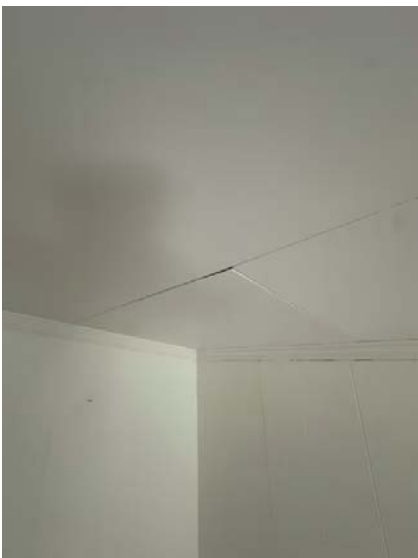
Det registreres heng/glipper ved takplater.
