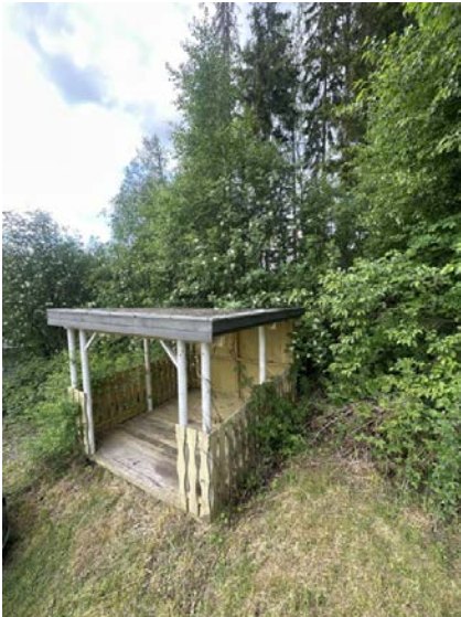
Viser overbygget plattform. Det registreres råteskader og skjevheter ved konstruksjonen. Ikke vurdert med tilstandsgrader.
