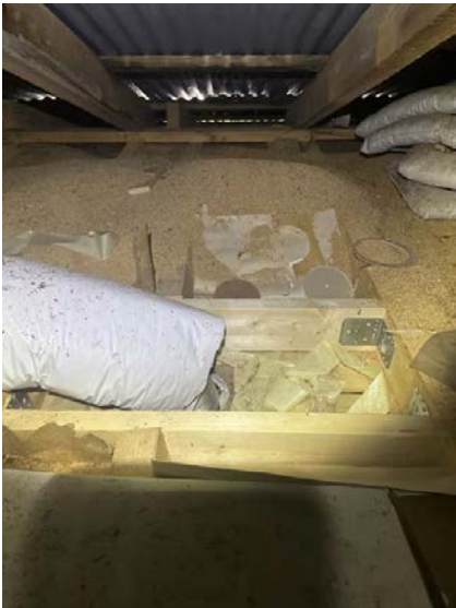
Mangelfull isolering hele veggen ved rør og i feltet rundt.
