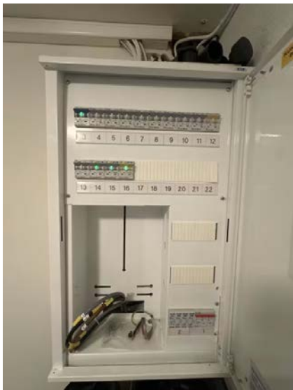
Viser sikringsskap plassert i kjeller. Måler plassert i skap i 1.etasje.
