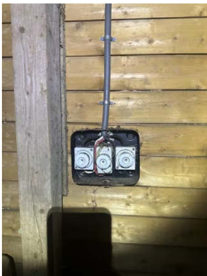
Inntaksikringer plassert på kaldtloft. Sikringsboks mangler avdekning (TG3)
