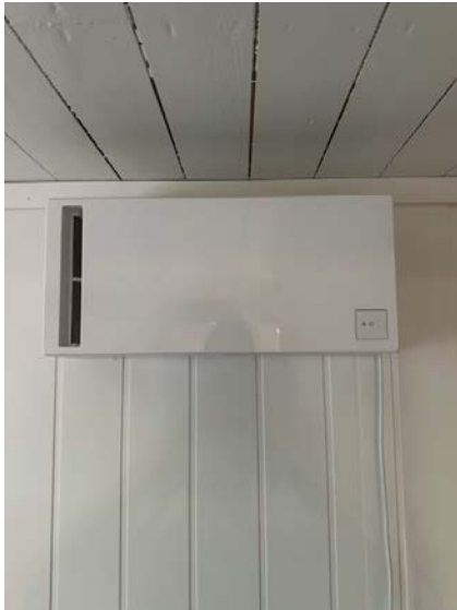
Enkelte rom med miniventilasjon.
