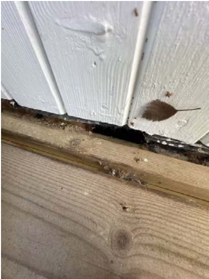
Det registreres utettheter ved yttervegg ved balkong i 2.etasje
