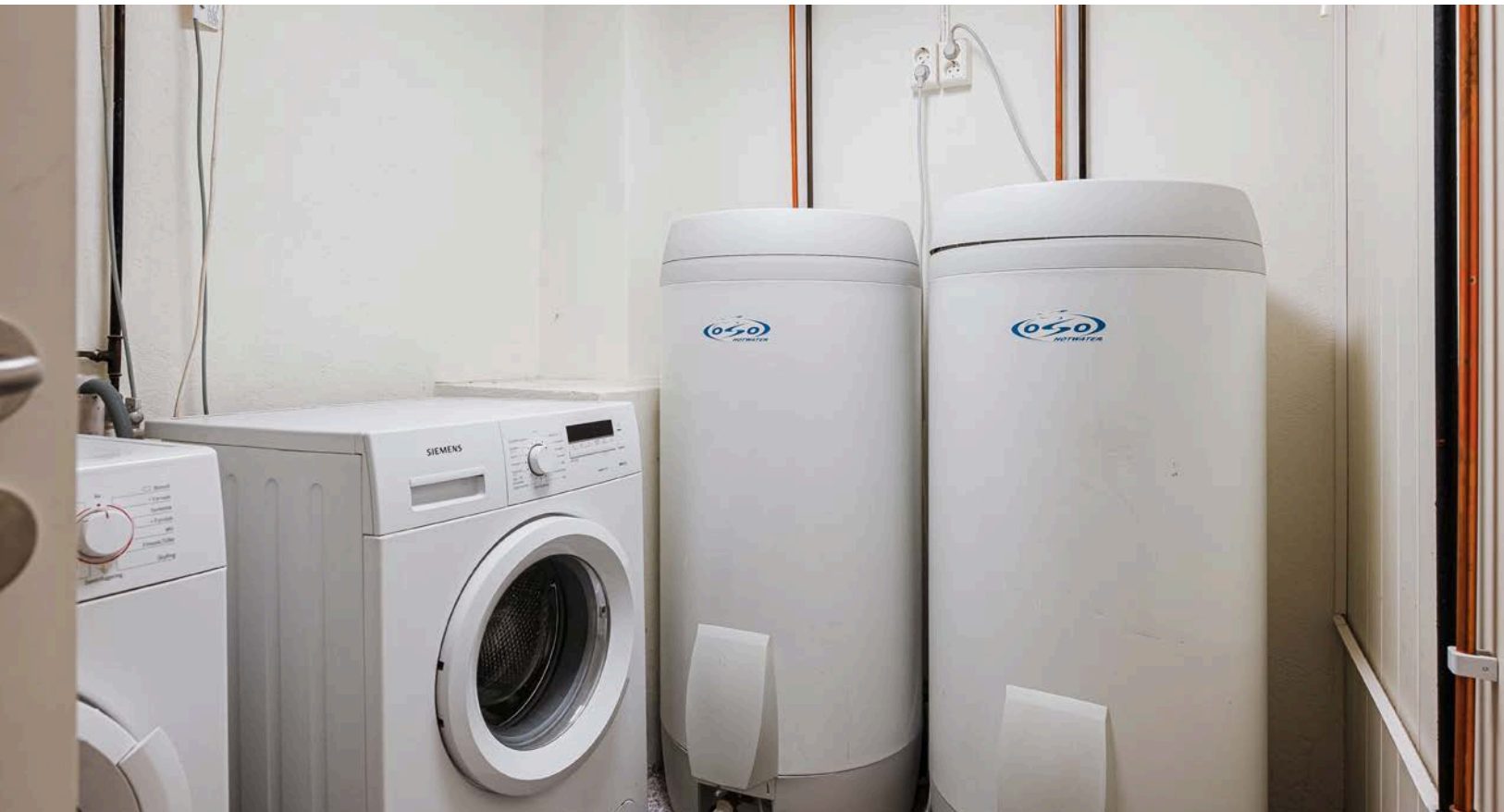
I kjelleretasjen er det etablert et felles vaskerom/teknisk rom for boenhetene.
