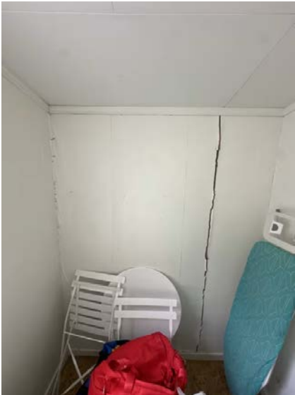
Viser skader på vegg i bod i 2.etasje etter tidligere vannlekkasje.
