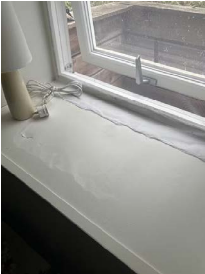
Utforing av gips utsatt for fuktighet. Utforing må byttes.
