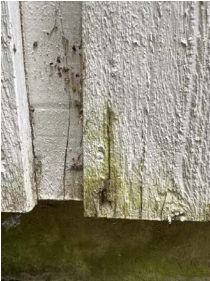
Det registreres stedvis råteskader ved kledningen.
