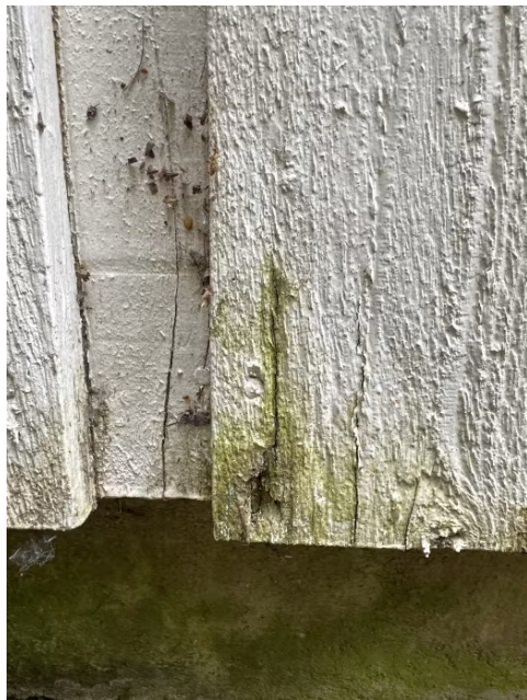
Det registreres stedvis råteskader ved kledningen.
