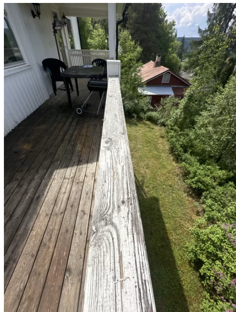
Konstruksjonen mangler overflatebehandling.
