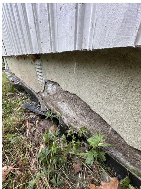
Grunnmur mangler stedvis overflatebehandling / puss.
