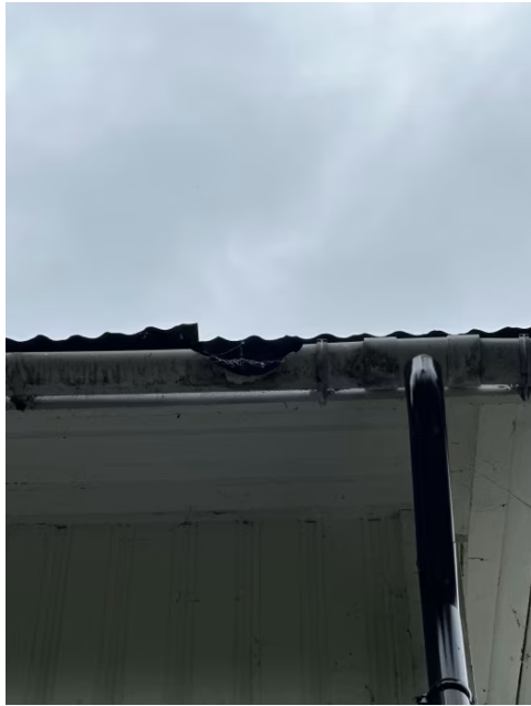
Viser sprekk i takrenne.
