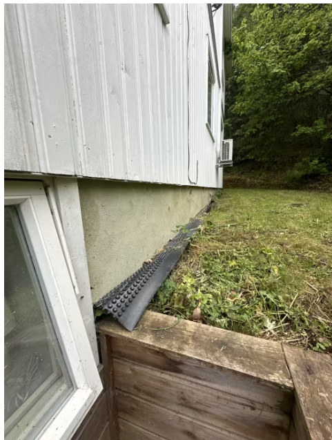
Viser manglende topplst ved knotteplast. Topplst må etableres ved knotteplast.
