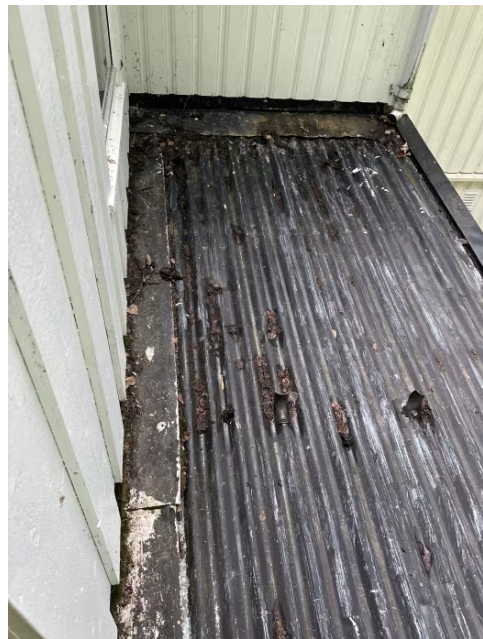
Viser slitasje ved tekking over inngangsparti.
