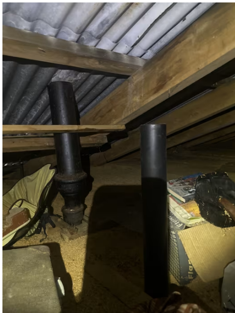
Lufting er ikke ført over tak. (TG2)
