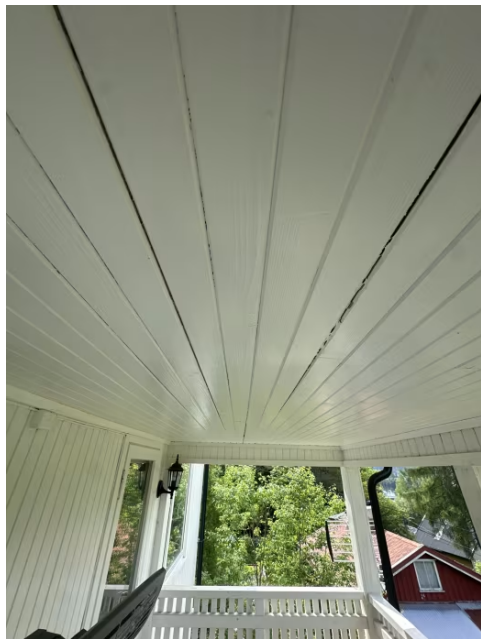
Det registreres sprekker i tak ved overbygg.
