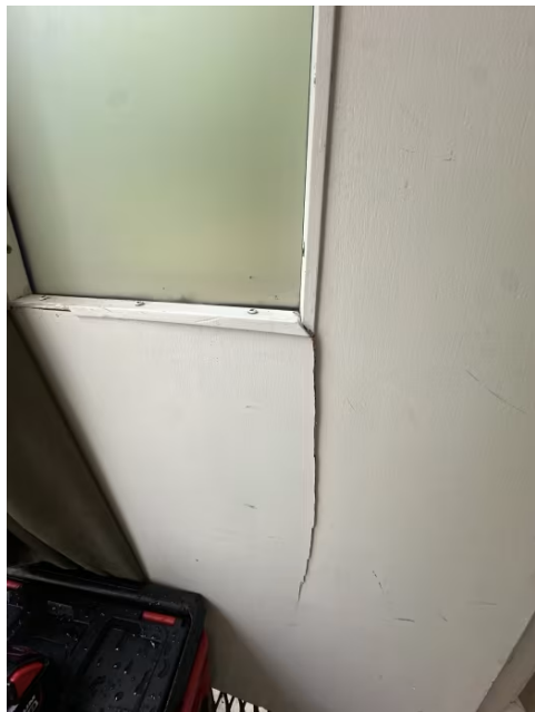
Viser skade på ytterdør.
