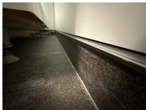
Det registreres manglende silikonefuge ved våtromsplater.
