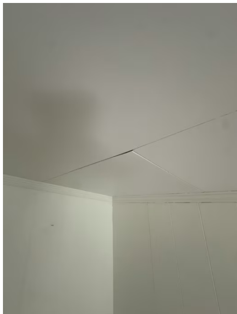
Det registreres heng/glipper ved takplater.
