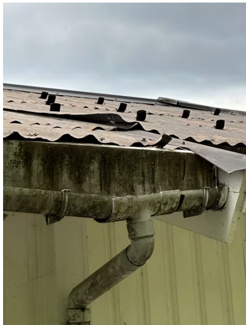
Viser skjevheter ved takrenner og løs taktekking.
