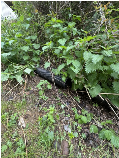
Viser drensør fra nedløpsrør. Eier opplyser om at det kan forekomme vond lukt fra drensør. Anbefaler yttersøkelser.
