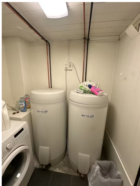
Viser beredere plassert på vaskerom i kjeller.
