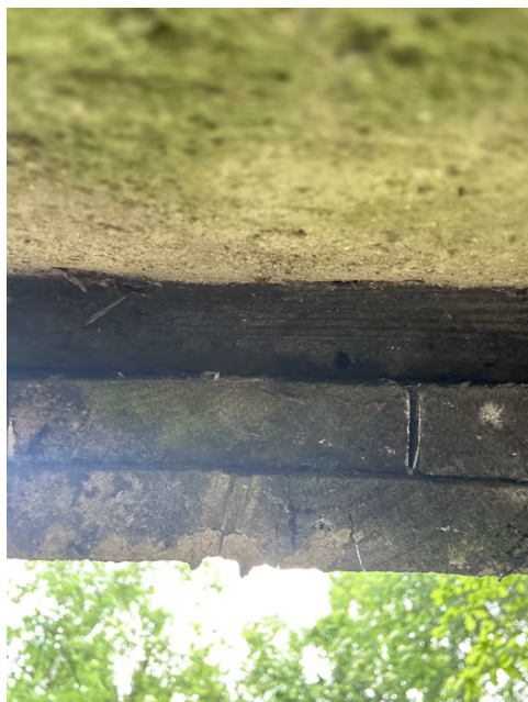
Det registreres manglende lufting bak kledningen.
