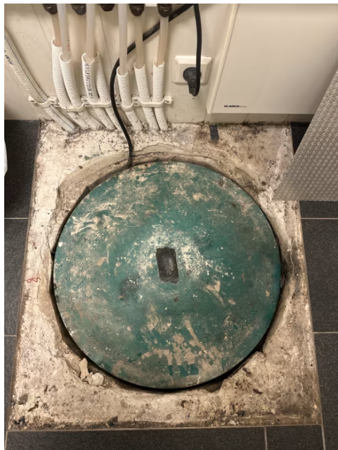
Viser pumpekum for avløpsanlegg i kjeller.
