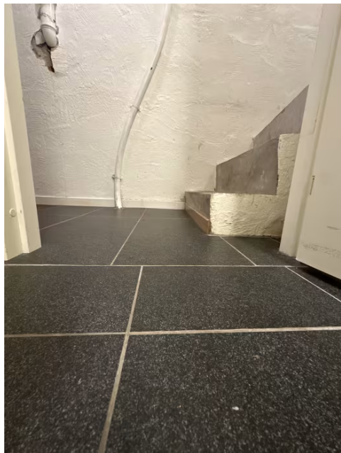
Ingen synlig tettesjikt ved døråpning.
