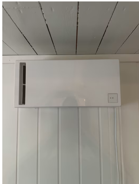
Enkelte rom med miniventilasjon.
