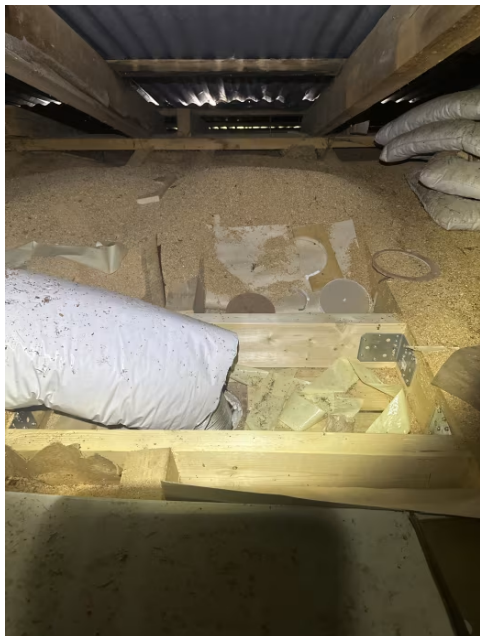
Mangelfull isolering hele vegen ved rør og i feltet rundt.
