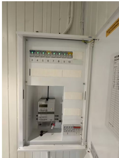
Viser sikringsskap i 1.etasje.
