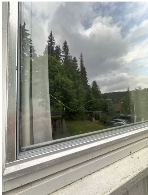
Viser knust glass ved vindu i 1.etasje
