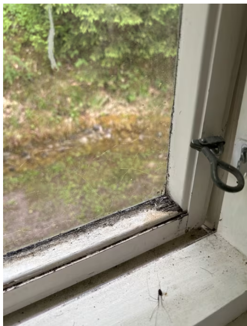
Viser eksempel på råteskade i vindu.
