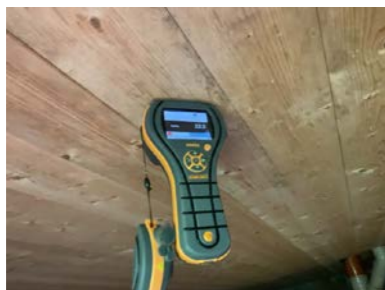
Fuktmåling, forhøyede verdier i treverk.
