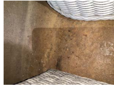
Vann registrert på gulv i kjeller.
