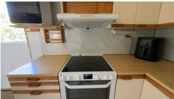
Montert avtrekk over komfyr.
