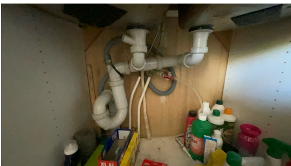
Del av rør til avløp.
