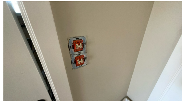
Eksempel elektrisk komponent som ikke har montert lokk.
