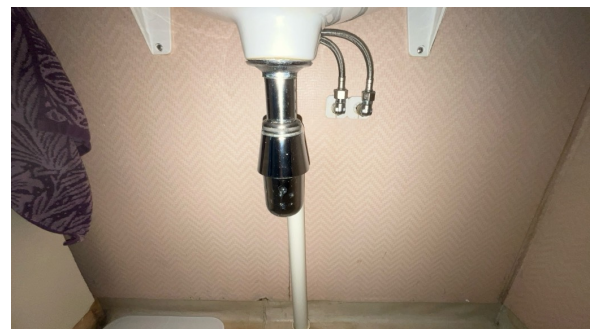
Del av rør til avløp.
