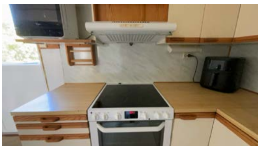
Montert avtrekk over komfyr.
