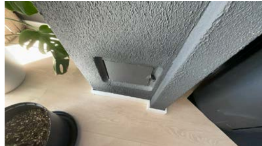
Del av pipe. Feieluke.
