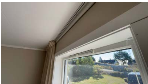
Eksempel på montert ventil i vindu.
