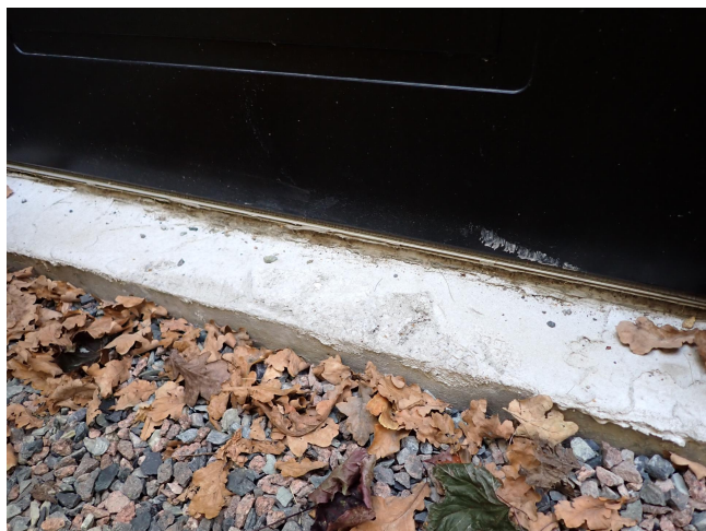
Manglende beslag under dør i kjeller.
