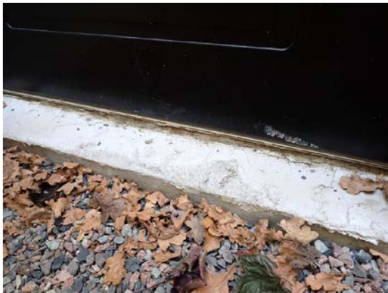
Manglende beslag under dør i kjeller.
