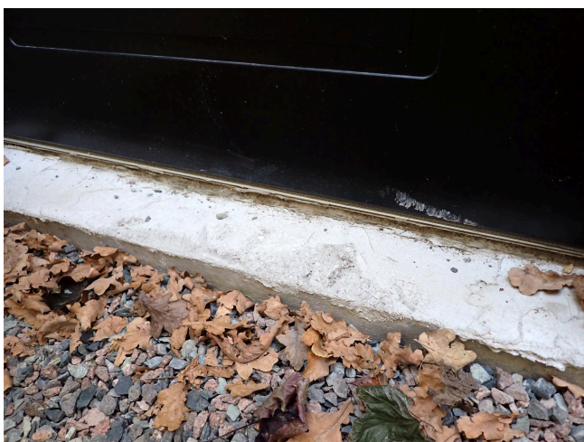
Manglende beslag under dør i kjeller.
