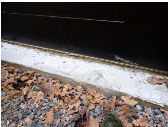
Manglende beslag under dør i kjeller.
