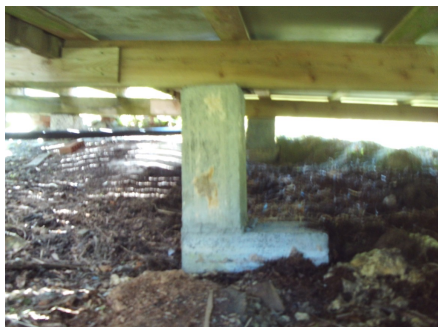
En del skjevheter på enkelte pillarer.
