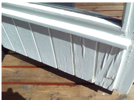
Slitt/skadet utvendig brystning
