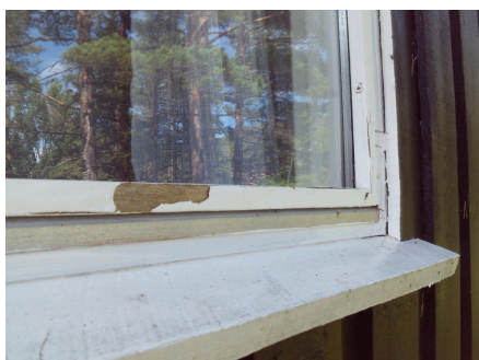
Noe slitasje på utvendig karm og ramme.
