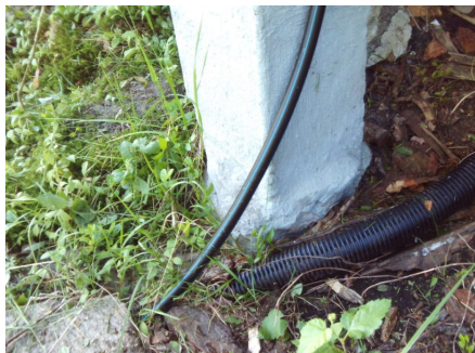
Ligger jordmasser inntil pillarer.
