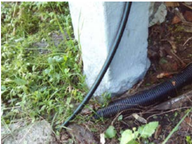
Ligger jordmasser inntil pilarer.
