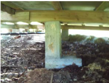
En del skjevheter på enkelte pilarer.
