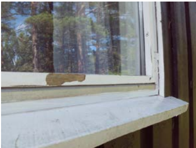
Noe slitasje på utvendig karm og ramme.
