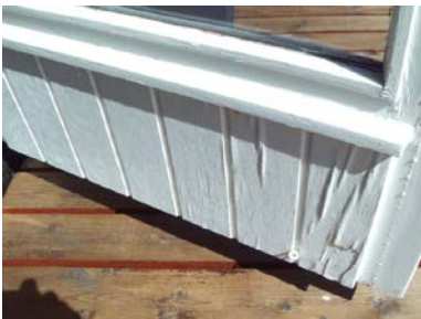
Slitt/skadet utvendig brystning
