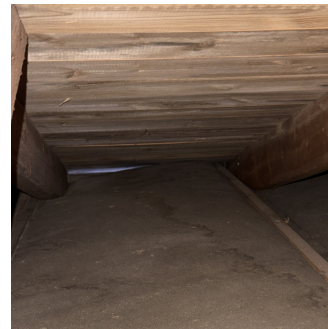
Redusert luftespalte ved takfot.
