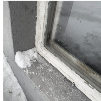
Manglende beslag og vedlikehold
