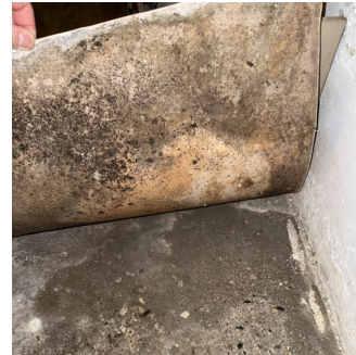
Fuktighet i gulv under belegg i gang
