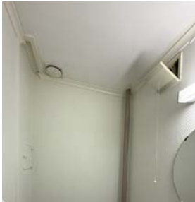
Ventil i vegg på toalett kommer fra bad.
