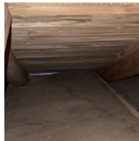
Redusert luftespalte ved takfot.
