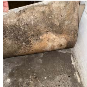
Fuktighet i gulv under belegg i gang
