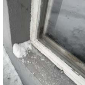
Manglende beslag og vedlikehold
