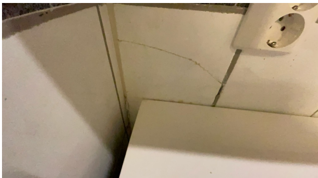
Sprukket flis på vegg.
