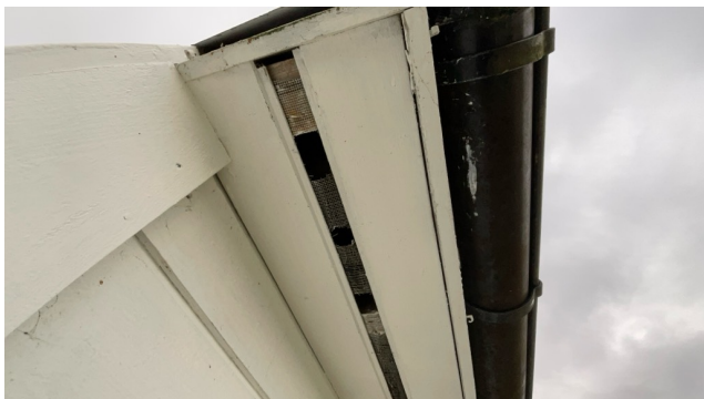
Defekt nett i luftespalter i takutstikk.
