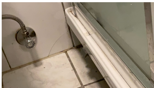
Sprukket flis på vegg ved dusjnise.
