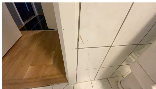
Sprukne fliser på vegg ved dør.
