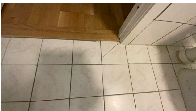
Sprukne fliser på gulv ved dør.
