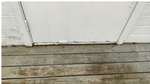
Værslitasje og nedbrytning i nedre kant av terrassedør.
