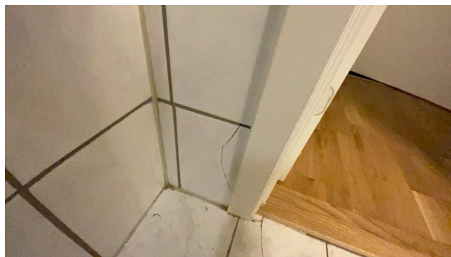
Sprukne fliser på motsatt side av dør.
