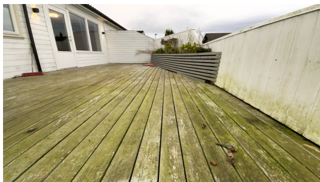
Omfattende skjevheter i terrassegulv.
