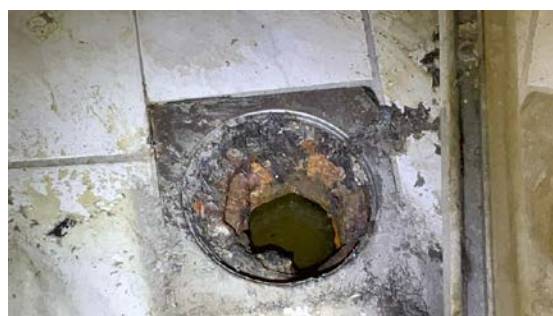
Eldre støpejernsluk i gulv, uten synlig membran.
