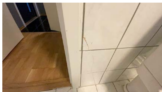
Sprukne fliser på vegg ved dør.
