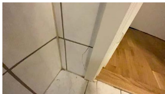
Sprukne fliser på motsatt side av dør.
