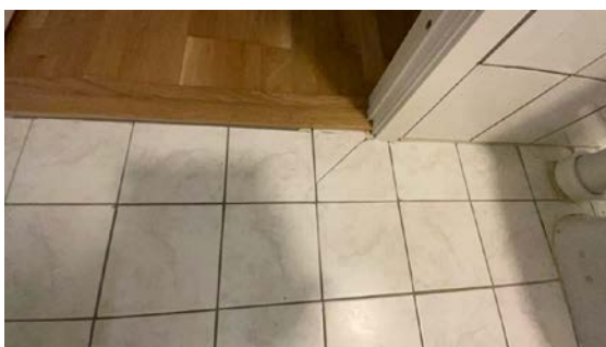
Sprukne fliser på gulv ved dør.
