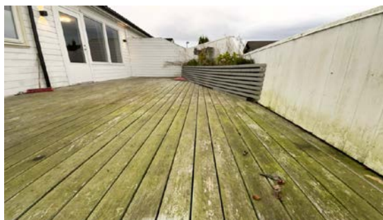
Omfattende skjevheter i terrassegulv.
