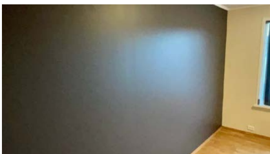
Plateskjøter på vegg i stue er ikke tilstrekkelig sparklet ut.
