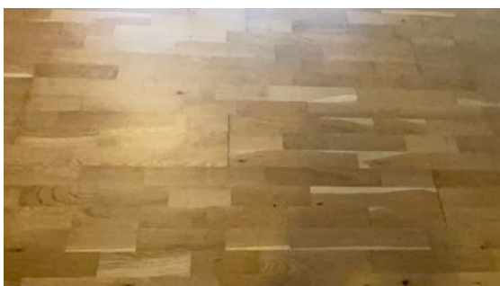
Det er påvist noe fuktmerker i enkelte parkettskjøter i stue.
