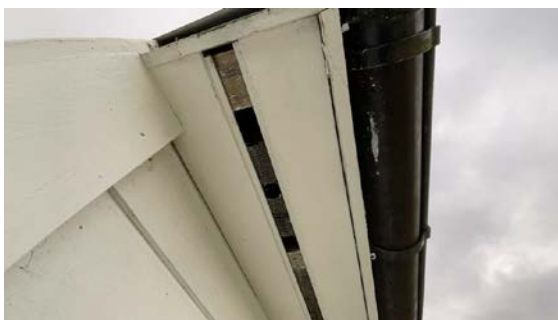
Defekt nett i luftespalter i takutstikk.
