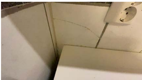
Sprukket flis på vegg.
