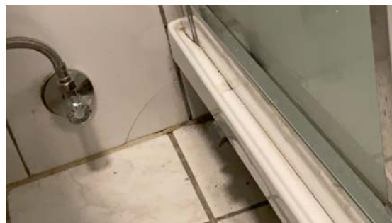
Sprukket flis på vegg ved dusjnisje.
