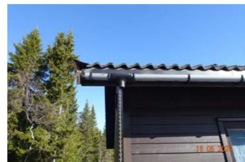
Kjetting som nedløp.
