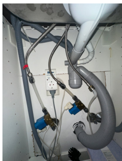
Røropplegg i kjøkkenbenk med Waterguard
