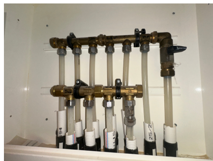
Samleskap med rørkurser og stoppekraner
