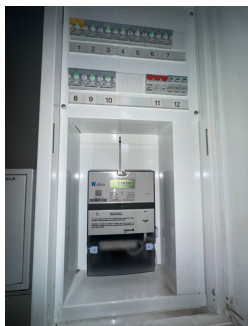
Sikringsskap med automatsikringer.
