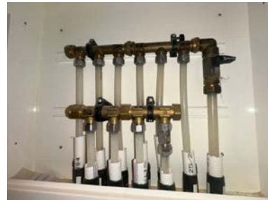
Samleskap med rørkurser og stoppekraner
