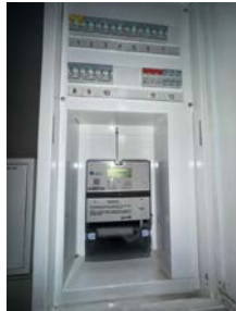
Sikringsskap med automatsikringer.
