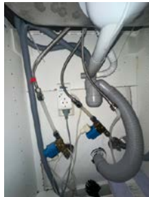
Rørøpplagg i kjøkkenbenk med Waterguard
