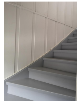
Trapp i 1. etasje mangler håndløper.
