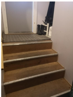
Trapp i kjeller mangler håndløper.
