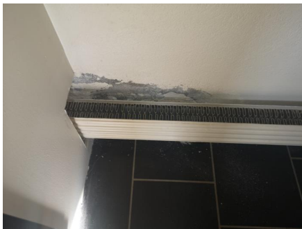
Fuktskader i grunnmur.
