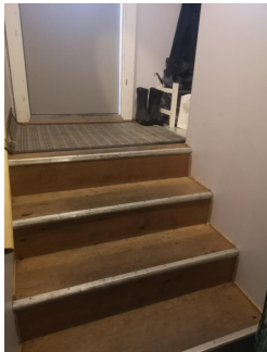
Trapp i kjeller mangler håndløper.
