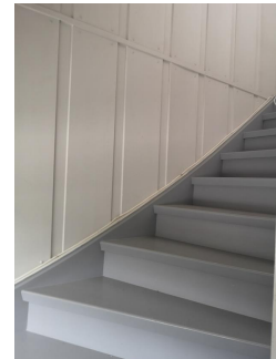
Trapp i 1. etasje mangler håndløper.
